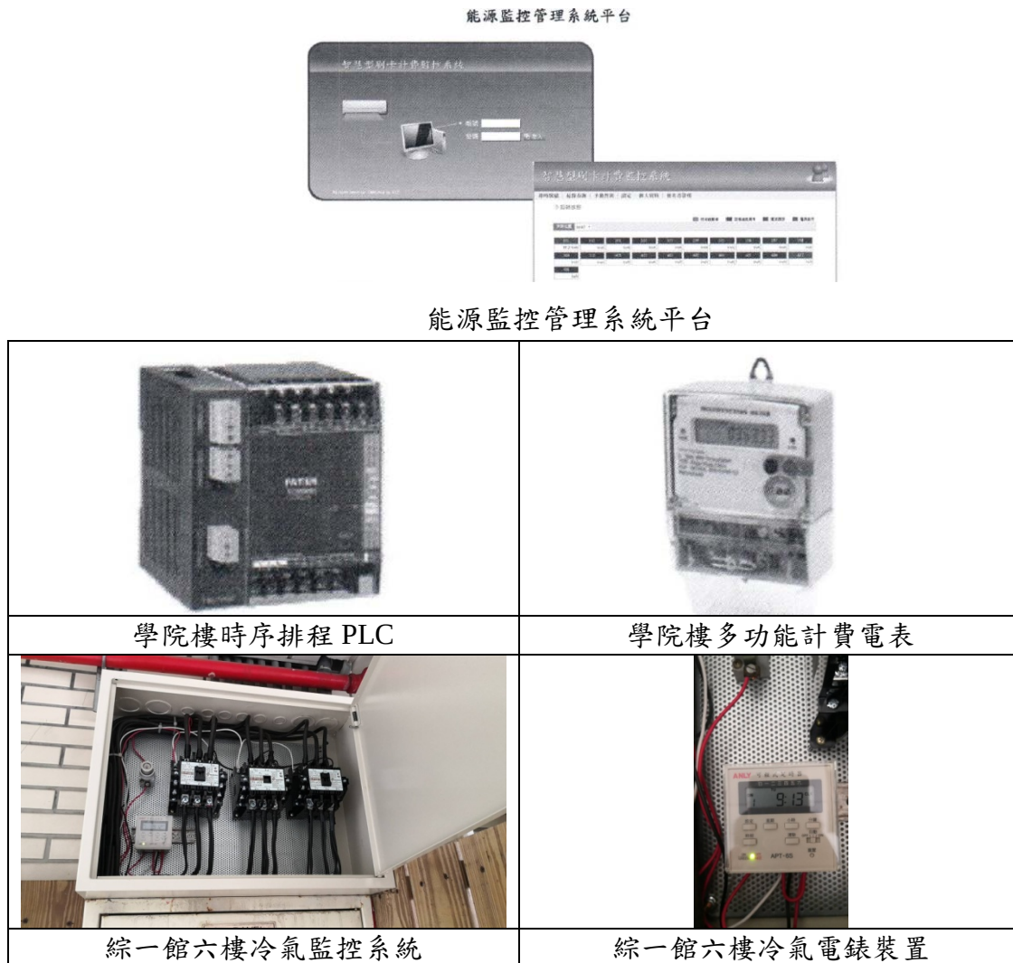
圖 3-3-3 能源監控管理系統平台與設備
